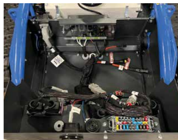
COMPARTIMENT ÉLECTRONIQUE câbles de communication pour pilotage des moteurs, déverrouillage du frein, point d'accès pour les lignes CAN bus etc...
